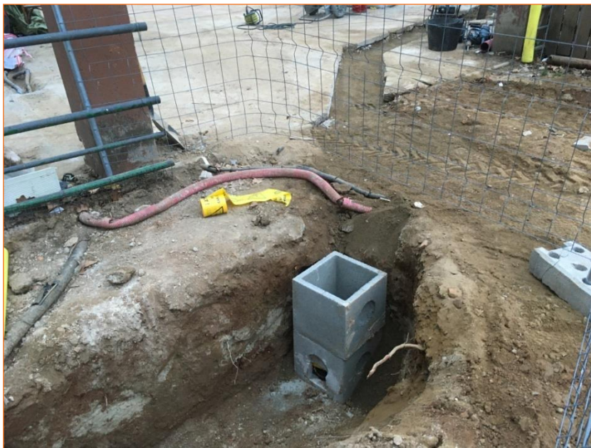
Foto 30. Vista del final de la rasa de serveis elèctrics, nivells UE 2, UE 16 i UE 17.
