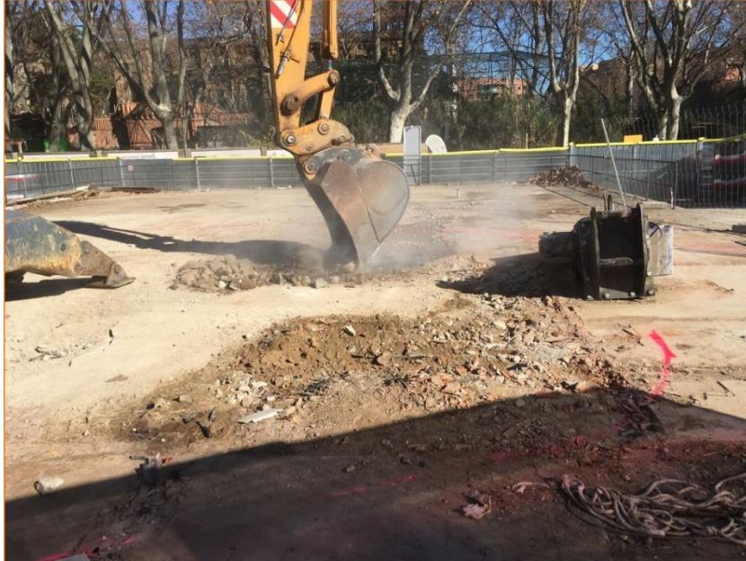
Foto 31. Vista dels treballs d'excavació del paviment UE 1 a la zona de l'estany.
